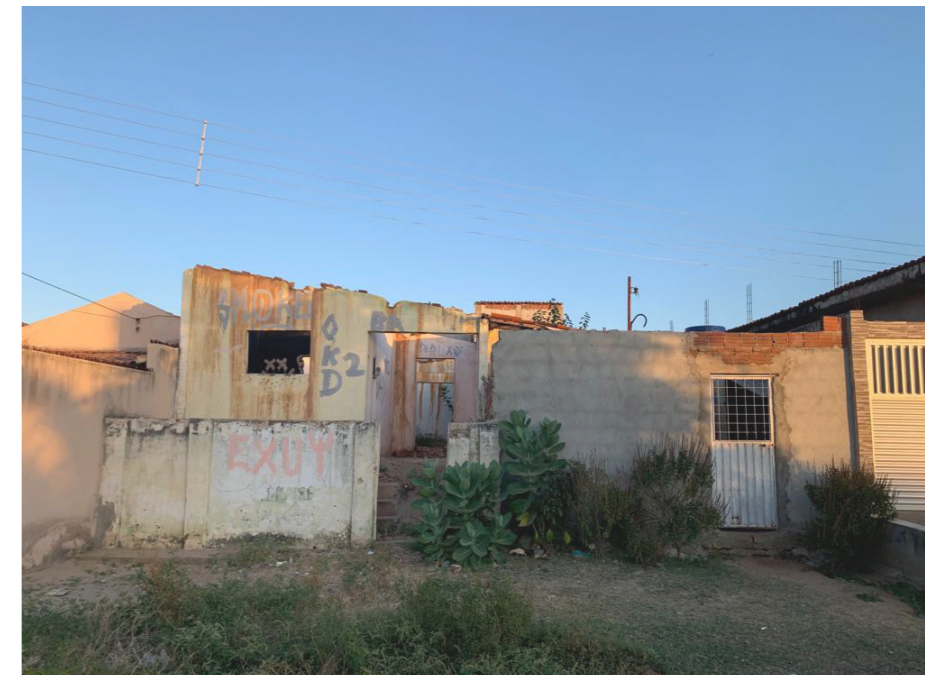
Figura 72: Residência em ruína da comunidade Beiral. Destaca-se as pichações com as siglas "OKD", uma referência à facção de tráfico "Okaida". Fonte: Autor
