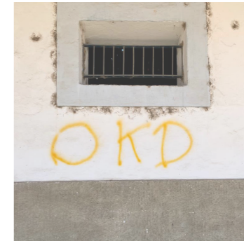
5. Pichações e Estrutura
