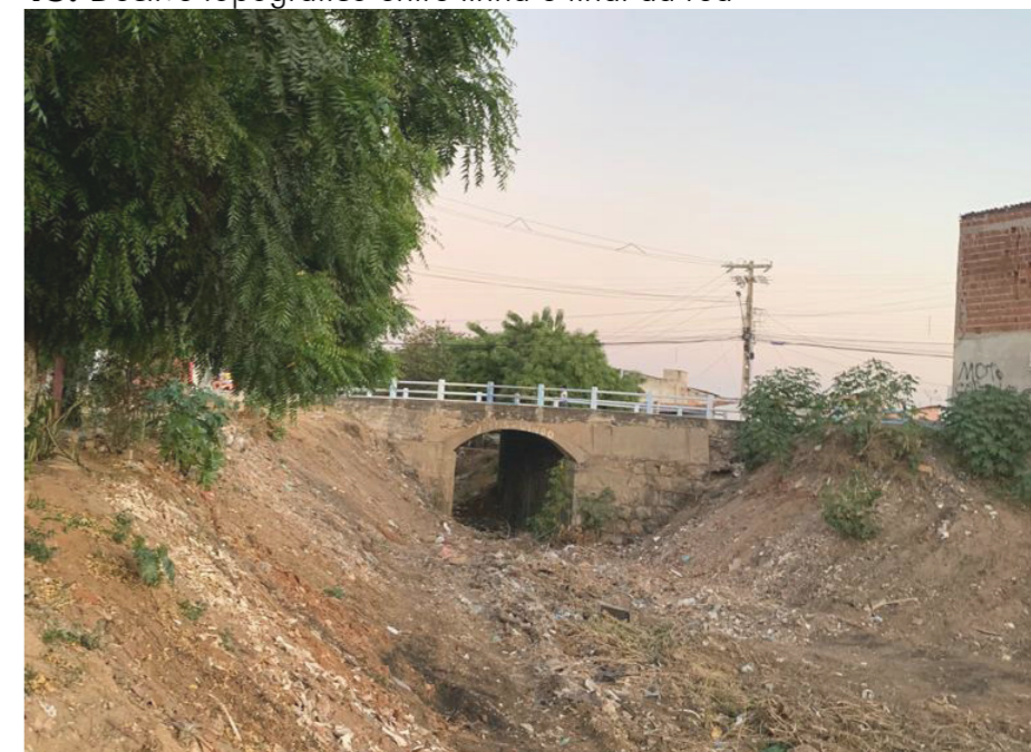
Figura 76: Declive topográfico da linha, na área final do recorte de estudo. Destaca-se a existência de uma ponte e um túnel, pelo qual o trem passava, quando a linha ainda era ativada. Fonte: Autor
